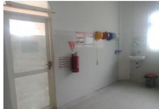
Gambar 10. Pemadam Api Ringan (Sumber hasil dokumentasi survei)
