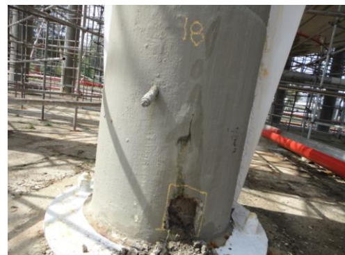
Gambar 2. Uji hole test korosi dibawah fireproofing
