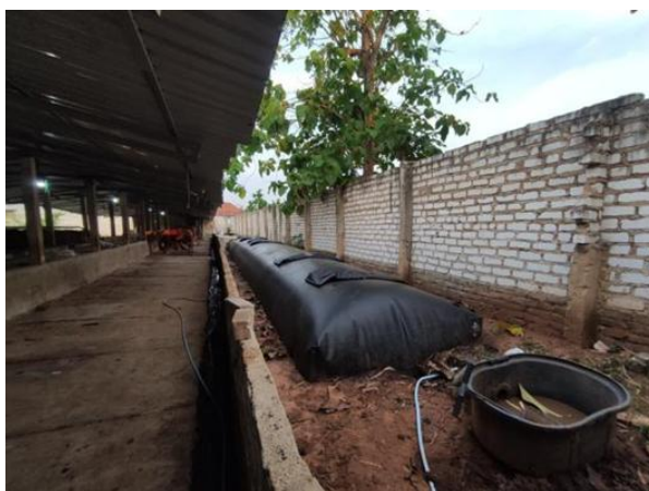
Gambar 3. Biogas Sistema kapasitas 40 m 3 .
