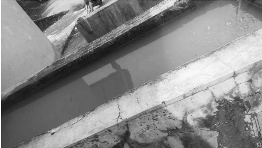
Gambar 1. Bak penampungan air yang tampak keruh
